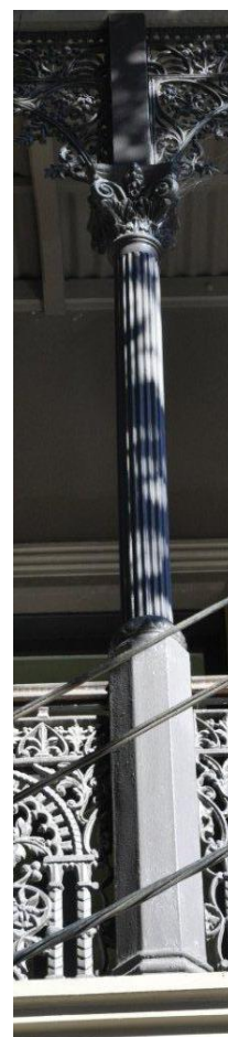
Med Column with 21A base in situ
